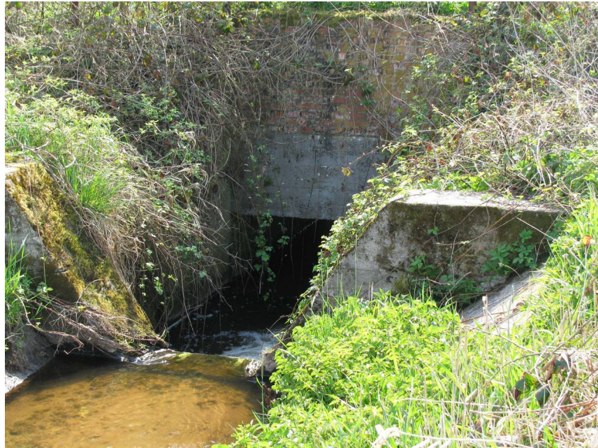
Abbildung 6: Beispiel der Brücken mit Absturz in der Wegebek an Station 2+631
